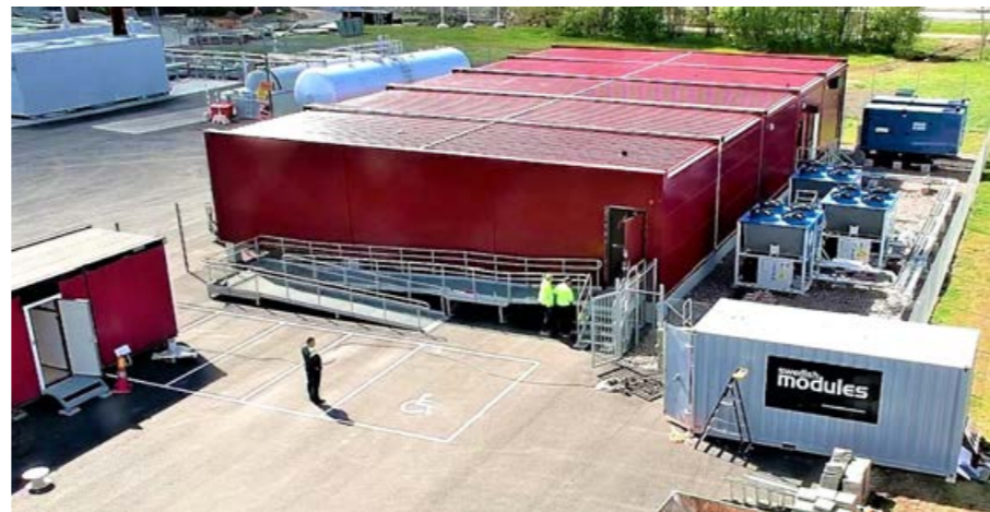
Datacentermoduler i Backa, Göteborg. Foto Göteborg Energi
